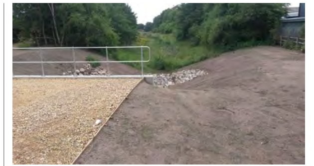
River Tutt Diversion Screen
